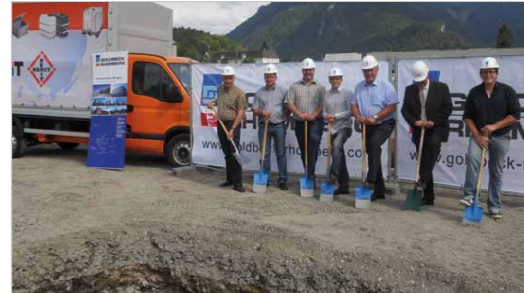
Der Spatenstich für die Betriebserweiterung ist erfolgt - die Fertigstellung ist für November geplant.
